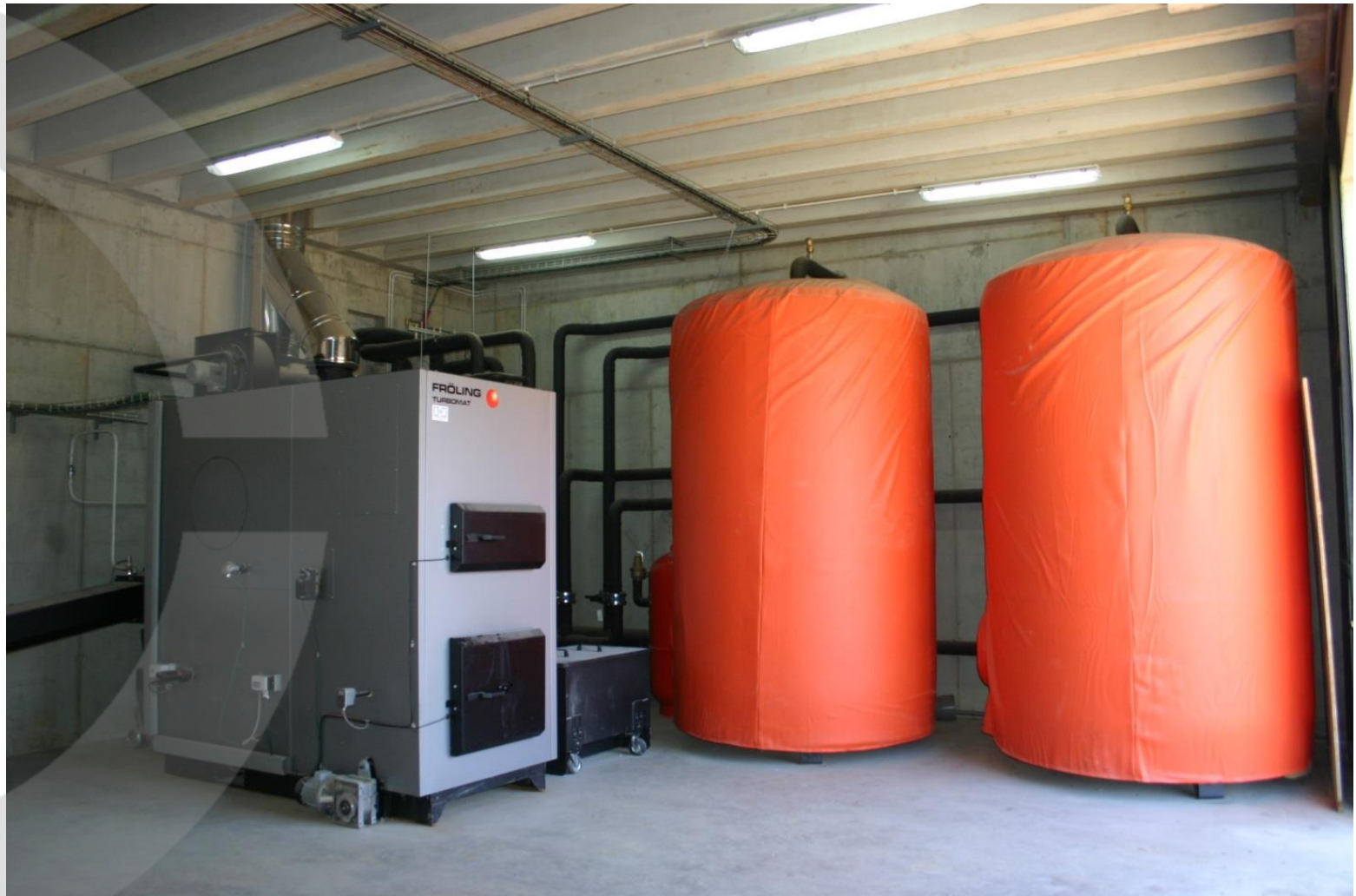
SALA DE CALDERES
