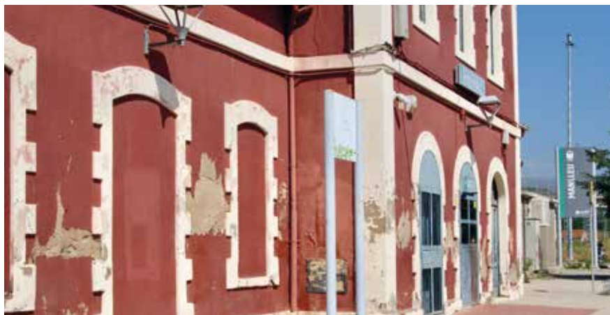
Façana deteriorada de l'estació de Manlleu.
