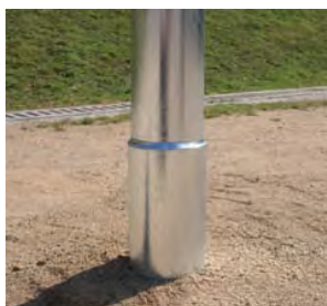
Detall de la base del pal reforçada
