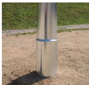
Detall de la base del pal reforçada
