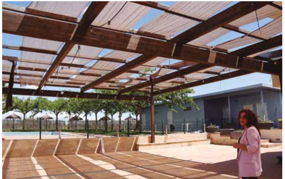
L'alcaldesa de Soses, Sandra Marco, sota el tendal instal·lat a la zona de les piscines.
